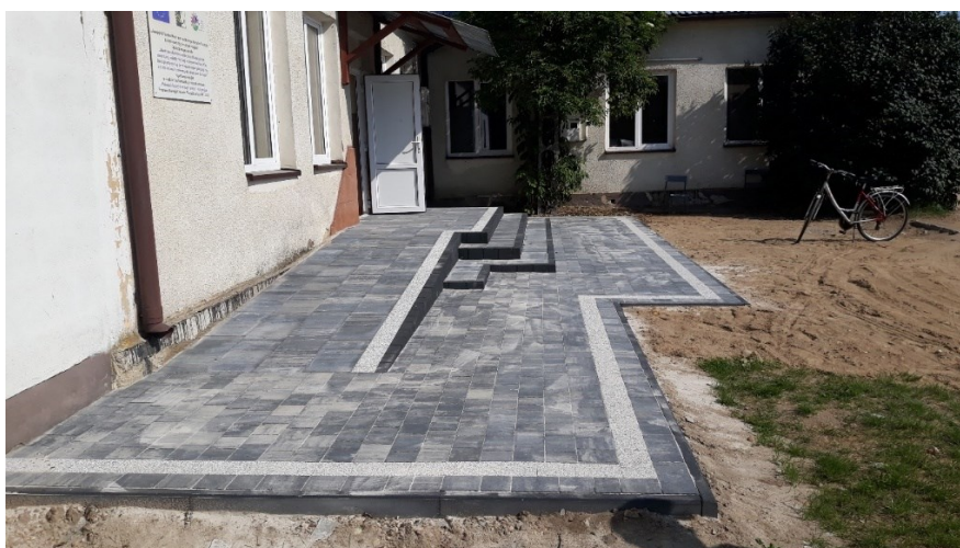
Rysunek 41 Schody po remoncie przy świetlicy wiejskiej w Nowej Wsi k/Duczymina. Źródło: Urząd Miasta i Gminy w Chorzelach
