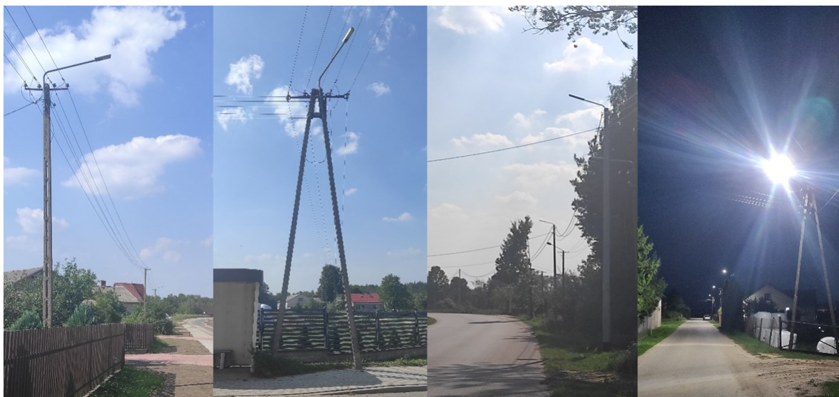
Rysunek 27 Zmodernizowane oprawy oświetlenia ulicznego LED o mocy 40W – 60W w miejscowościach (od lewej): Łazy, Gadomicz Miłocięta, Brzeski Kołaki, Lipowiec, Źródło: Urząd Miasta i Gminy w Chorzelach.
