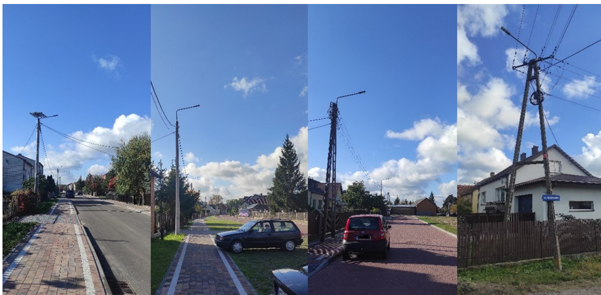
Rysunek 28 Zmodernizowane oprawy oświetlenia ulicznego LED o mocy 40W w miejscowości Chorzele (od lewej): ul. Nowa, ul. Cmentarna, ul. Rzemieślnicza, ul. Wiatraczna, Źródło: Urząd Miasta i Gminy w Chorzelach.
