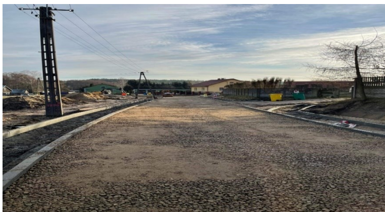
Rysunek 36 Droga gminna w miejscowości Stara Wieś w trakcie rozbudowy – odbiór częściowy 29.12.2023r., źródło: Urząd Miasta i Gminy w Chorzelach.
