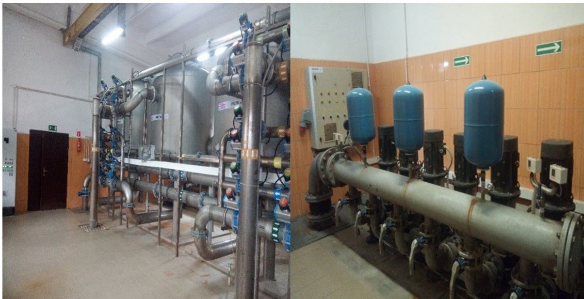
Rysunek 164 Hala technologiczna na Stacji Uzdatnia Wody w Chorzelah, źródło: ZGKiM w Chorzelah
