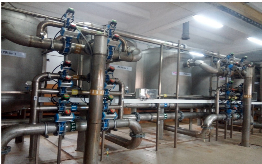
Rysunek 130 Hala technologiczna na Stacji Uzdatnia Wody w Chorzela, źródło: ZGKiM w Chorzela
